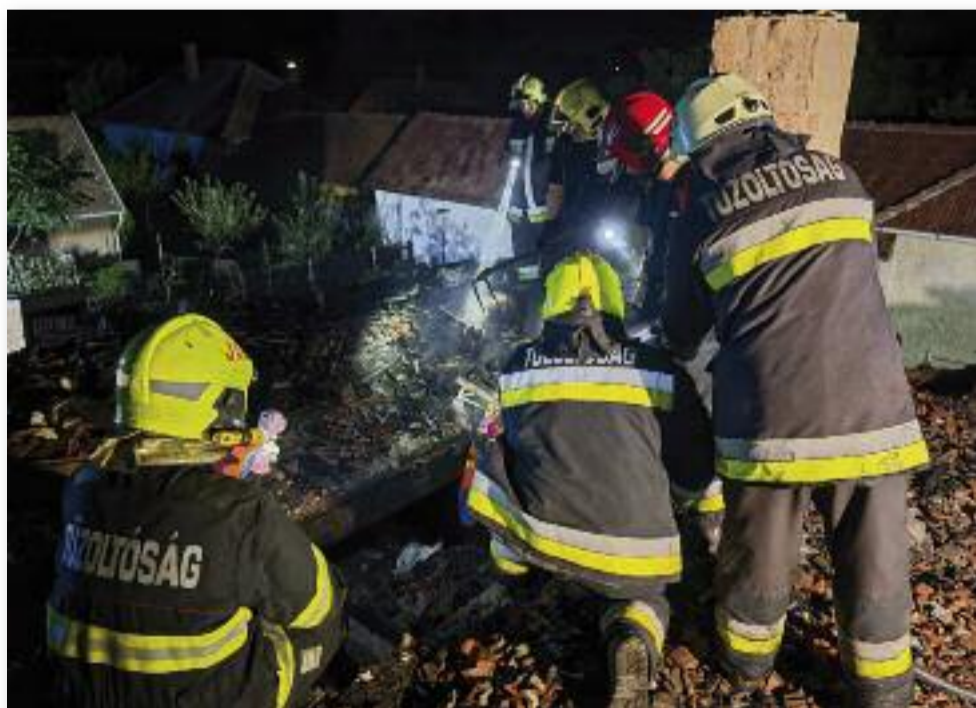
Jászdózsai családi ház tűz következtében leszakadt tetőszerkezetének vizsgálata, utómunkálata
